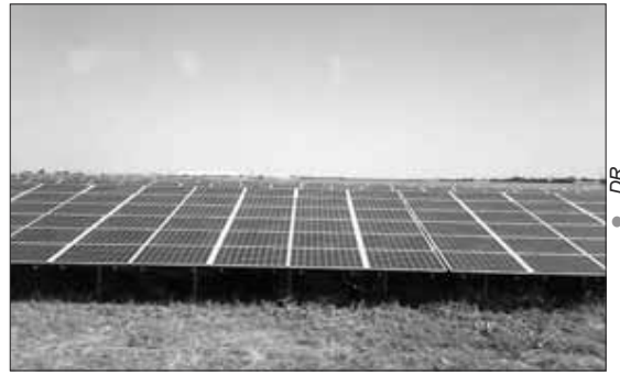
... la centrale photovoltaïque de 33 MW
